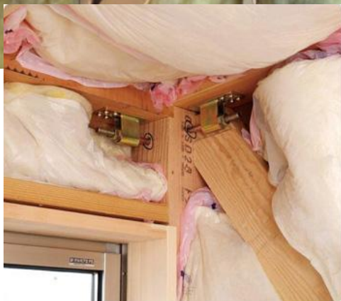
筋交の部分に隙間ができています
